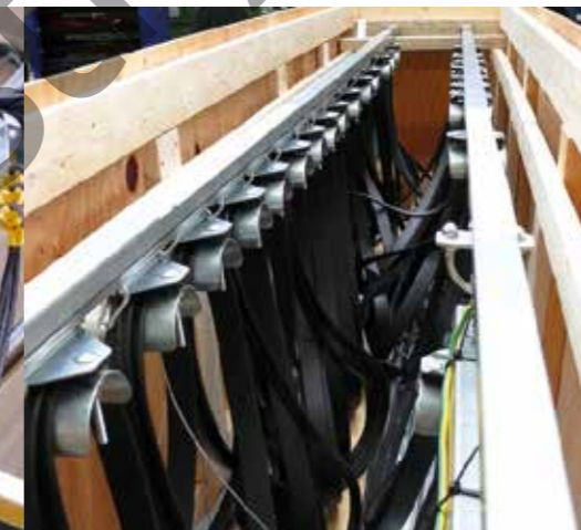
Готовый к эксплуатации блок питания тали
